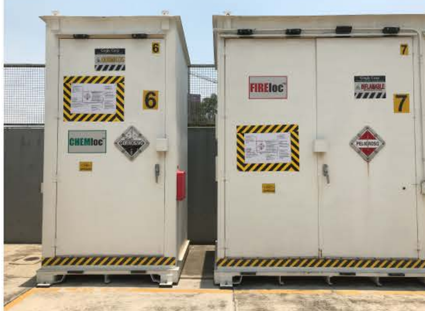
Imagen 5. Manejo de sustancias químicas peligrosas con Gabinetes Exteriores con resistencia al fuego.
