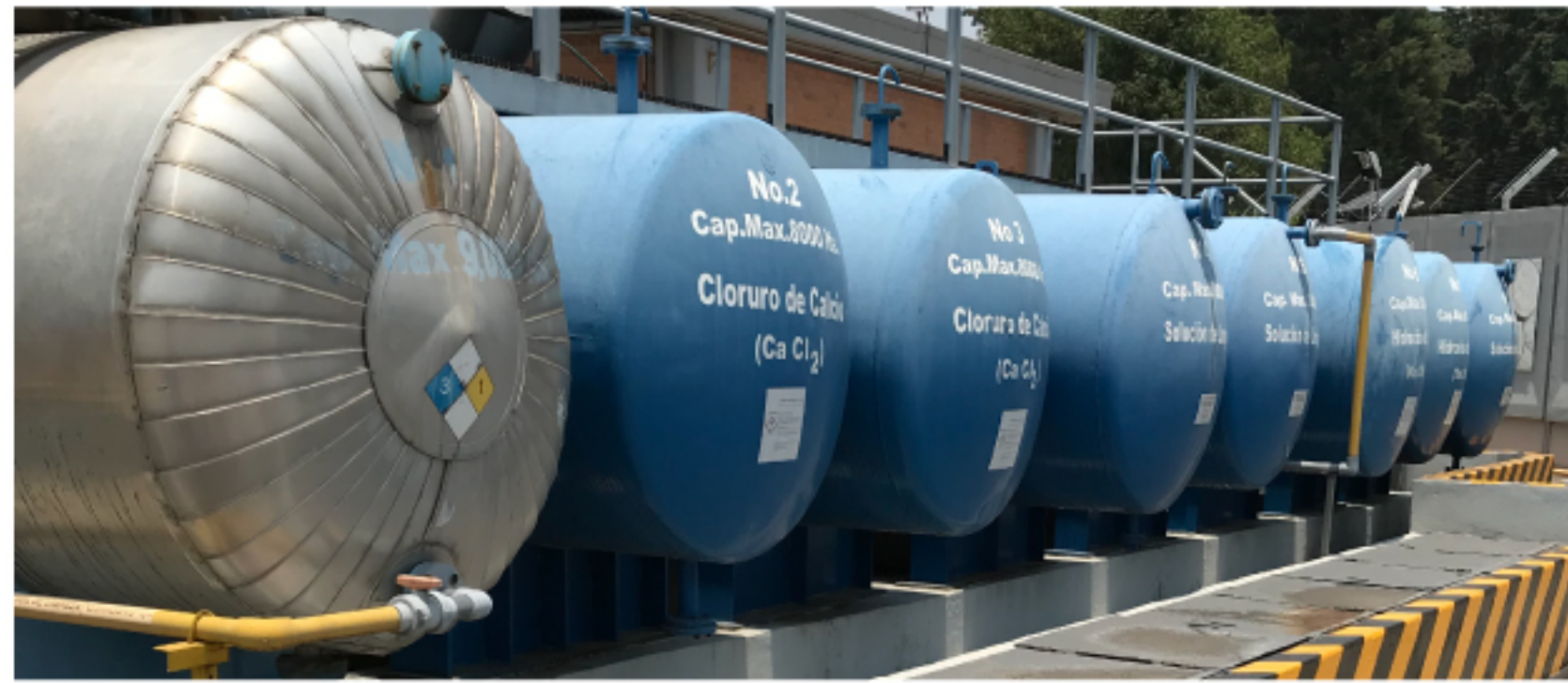
Imagen 3. Tanques atmosféricos que contienen residuos peligrosos y sustancias químicas peligrosas para la impresión de billetes del proceso calcográfico.
